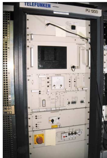
Steuerteil des von Telefunken hergestellten 1-MW-Senders TRAM 1000S
