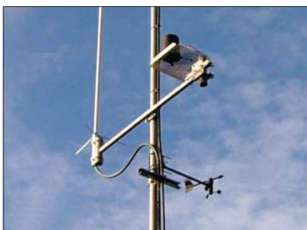
X-50-Antenne sowie Regen- und Windsensor der WX-Station des APRS-Digis DB0HWR-5
