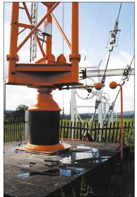
Isolierter Mastfuß eines der vier 227 m hohen Antennenstrahler mit Funkenstrecke
